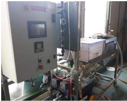
Figure 1 : Installation pour les essais pilotes
